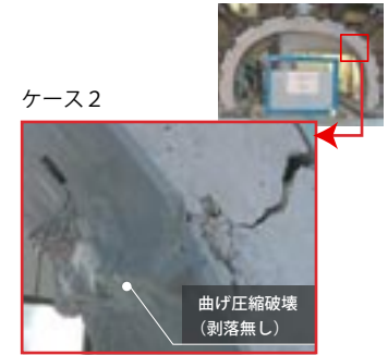
タフネスコート (1.5mm) で被覆したコンクリート覆工 (鉛直変位 δ=70mm時)
