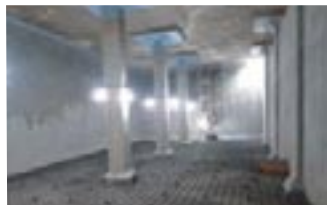
上水用配水池／防火水槽など
